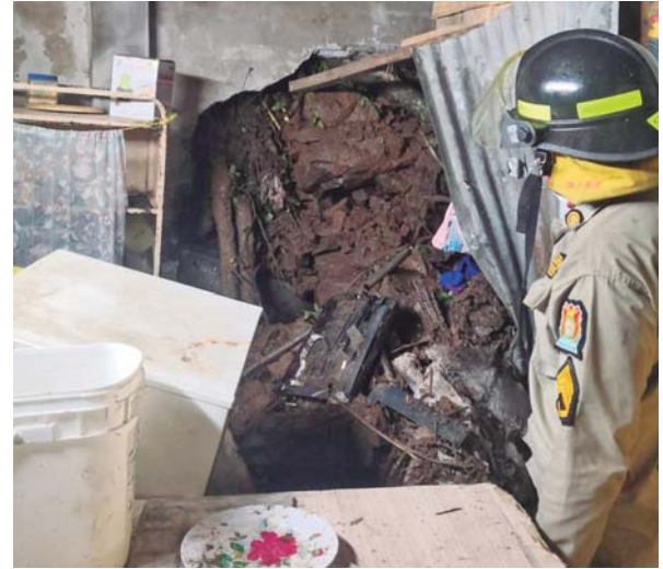
En la colonia La Soledad, de Comayagüela, varios vecinos reportaron el colapso de una pared de una vivienda, debido a un alud de tierra.
