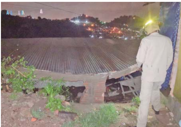
Las bases de una de las paredes de la iglesia Nueva Jerusalén, construida de piedra y ubicada en la colonia Venezuela, de Comayagüela, colapsaron por completo.
