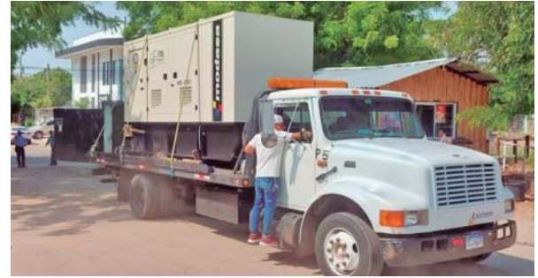
Con el nuevo generador de energía se evitará problemas al suspender el sistema eléctrico externo.
