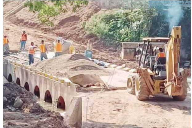
Con las tormentas tropicales Eta y Iota, muchos tramos de la carretera del occidente se encuentran en proceso de reparación.
