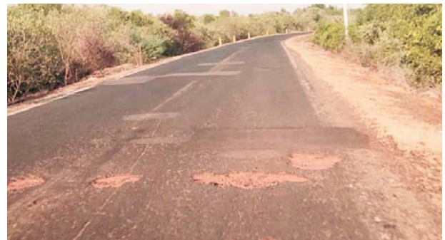
Las carreteras están prácticamente destruidas en muchos sectores del país, por lo que urgen de reparación.
