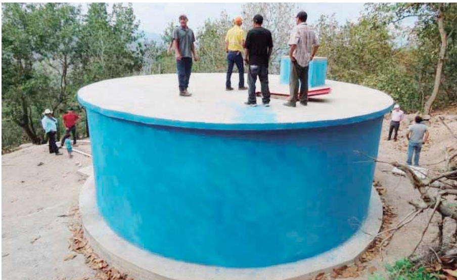
Un moderno tanque cisterna almacenará el líquido para los pobladores de la comunidad de Las Anonas.
